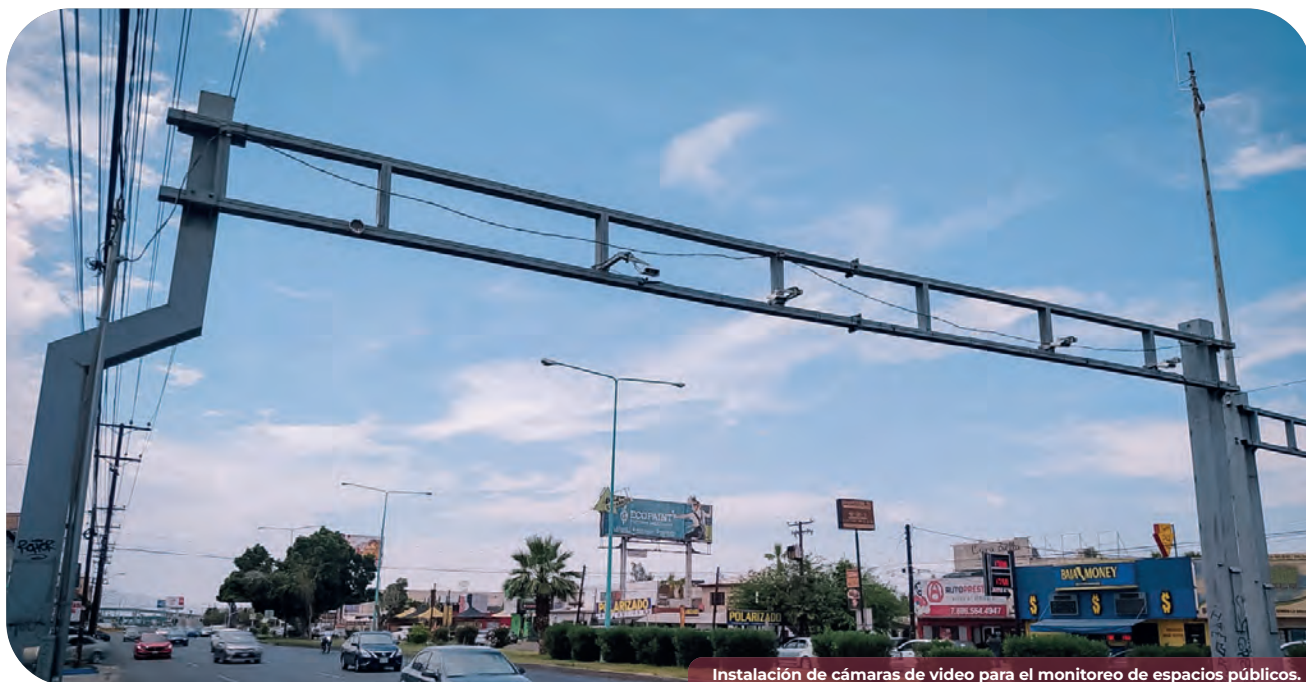
Instalación de cámaras de video para el monitoreo de espacios públicos.
